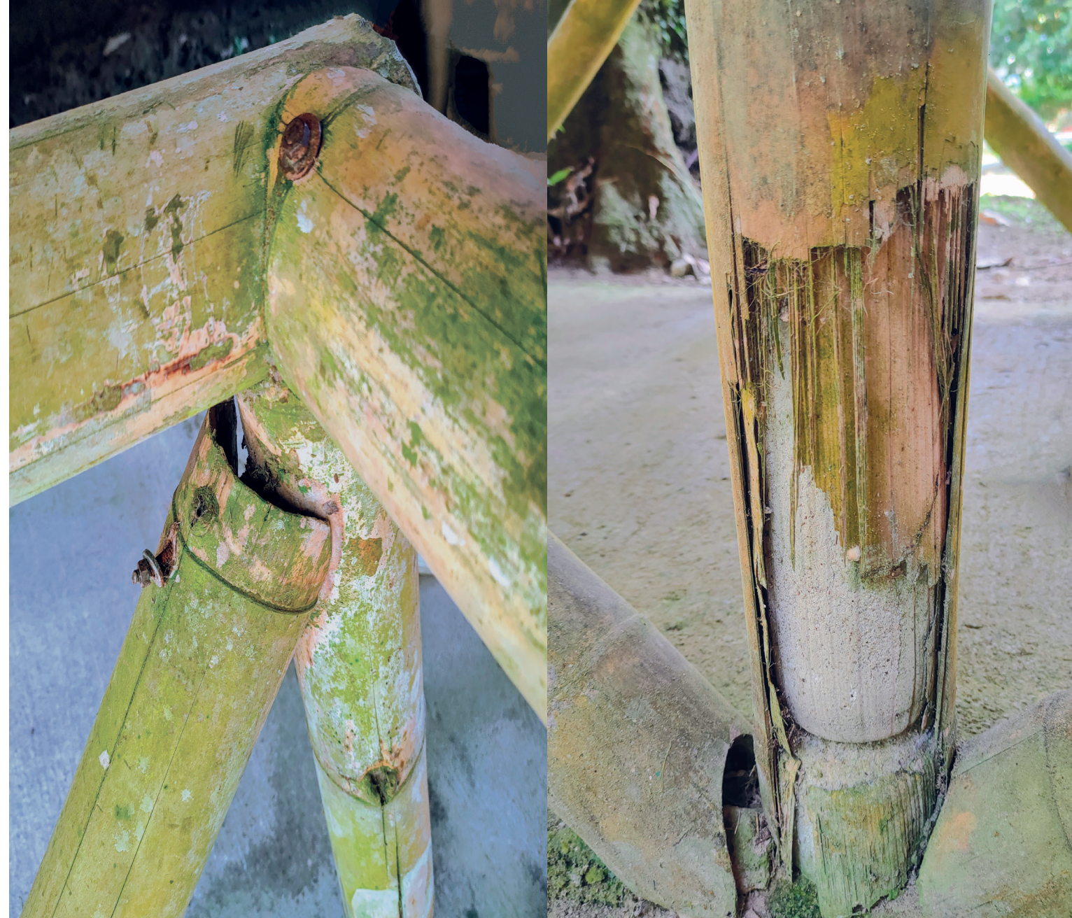
Foto No. 05. Deterioro por intemperie La imagen muestra el deterioro del bambú por estar expuesto a las condiciones de la intemperie en el Parque La Isla, en Tena.
